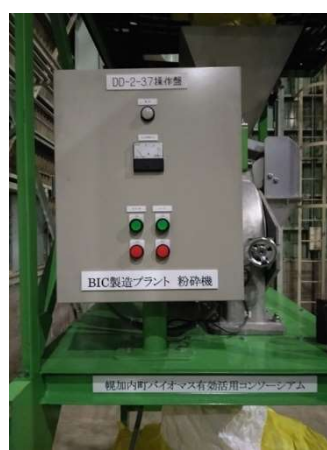
写真5 マキノ式粉砕機の制御盤
